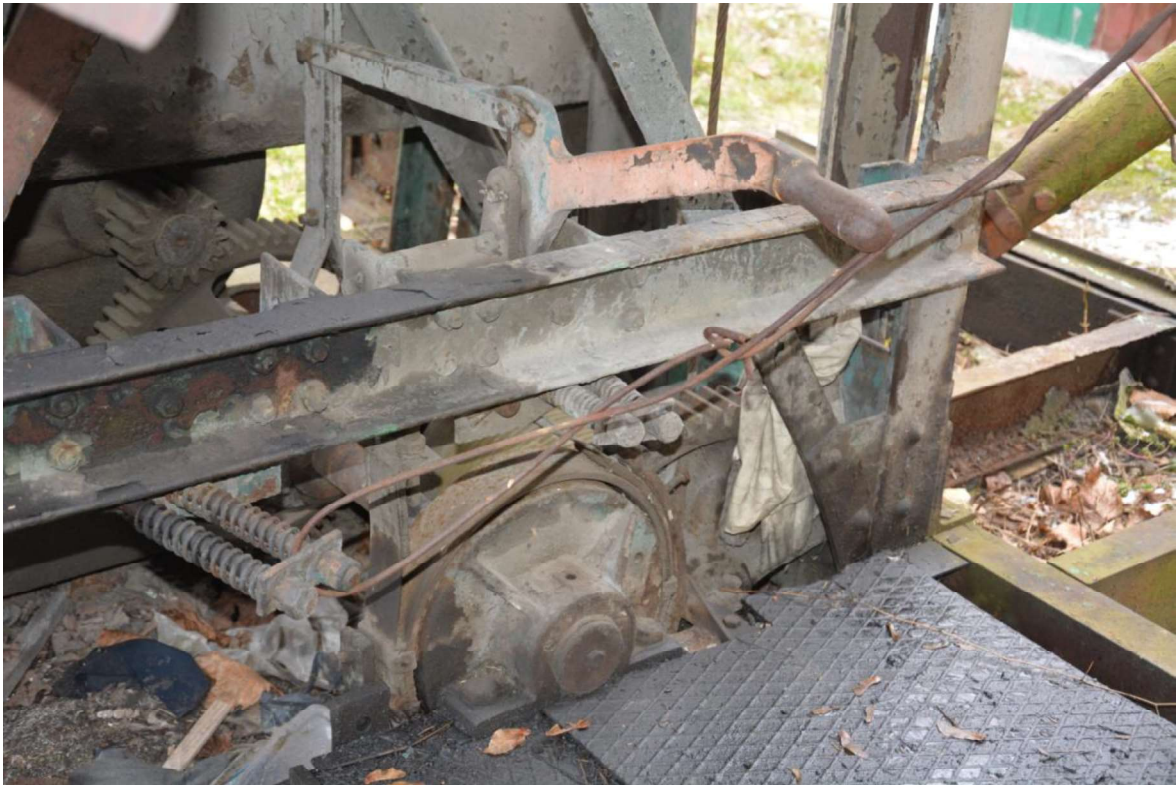
Zdj.7. Żuraw, napęd podciagu wysięgu - stan przed konserwacją
