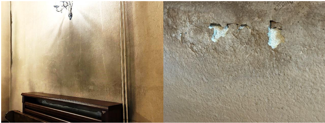
Fot. Widoczne lokalne silne zabrudzenia i miejscowe destrukty na ścianach we wnętrzu kościoła
